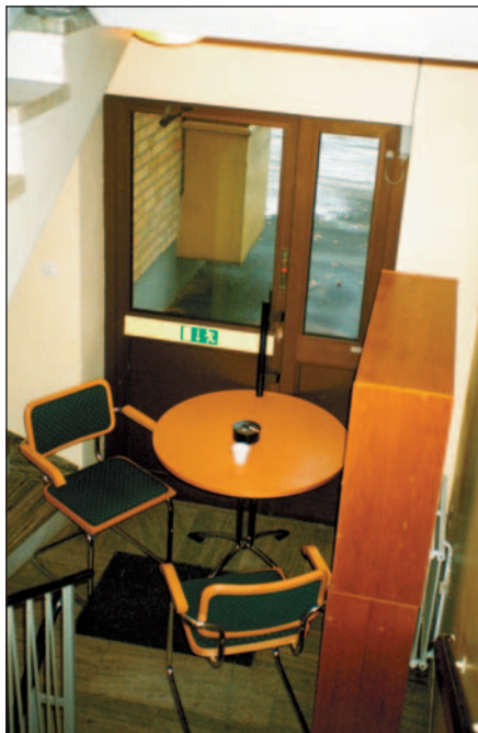
Så här får det inte se ut. Rökhörna i utrymningsväg
